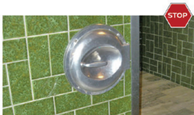
Conductos de evacuación de basuras.
